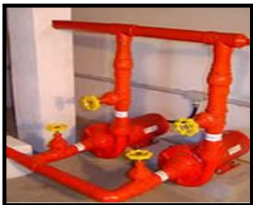
Figura 16 - Bomba de Incêndio
